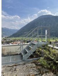
Zugang Aussenleiter GSM-Antenne Ebene 7
