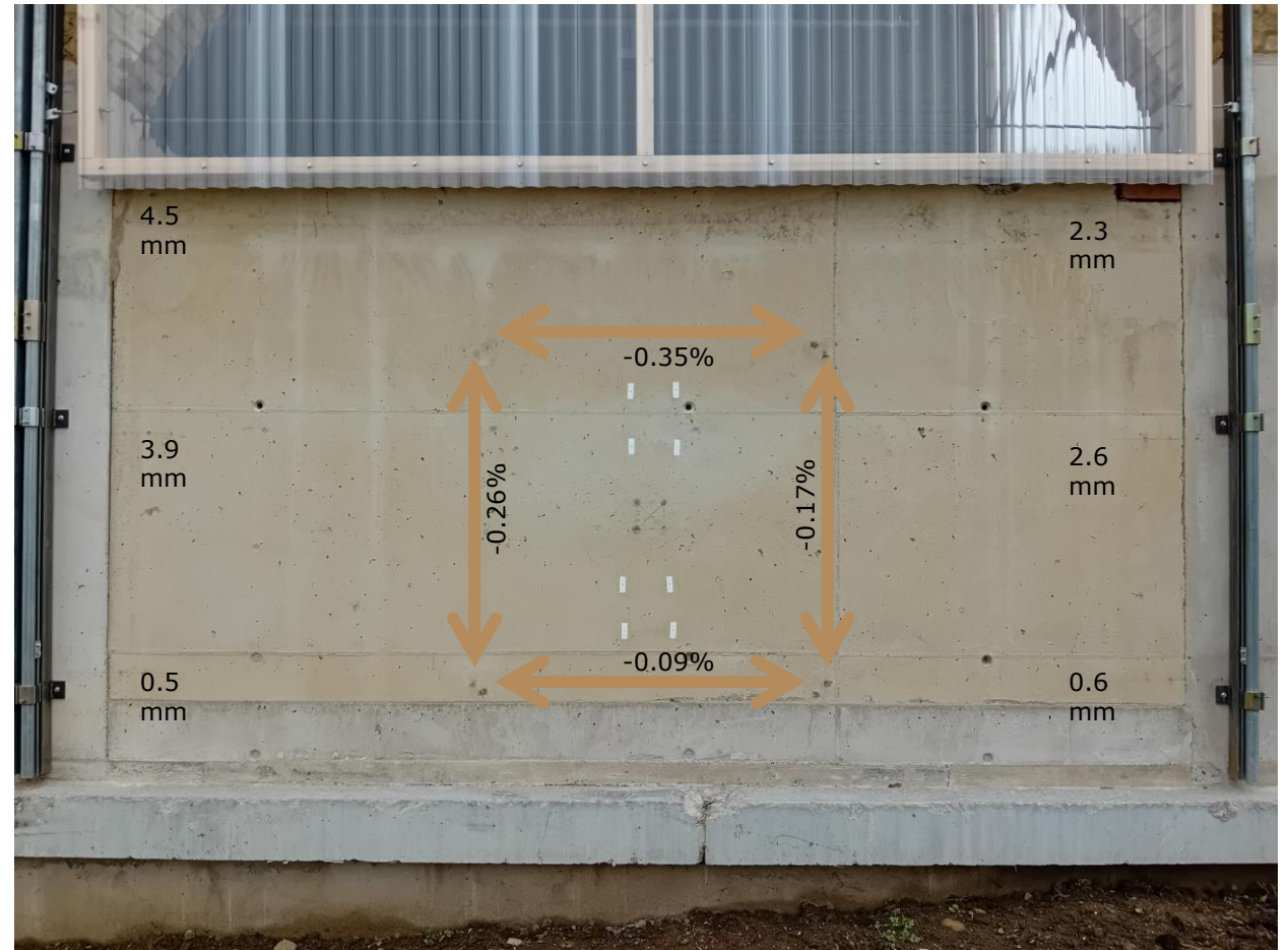
Südwand gross, Rissweitenzunahme & Schwinden ab Tag 10
