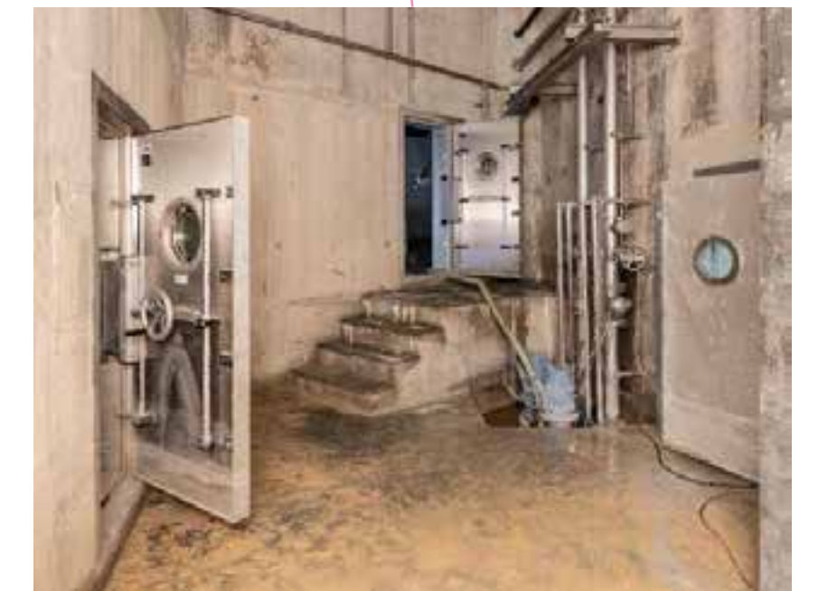
St. Gallen: Unterirdisches Retentionsbecken
